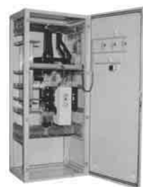
Transferencia automática en caja
